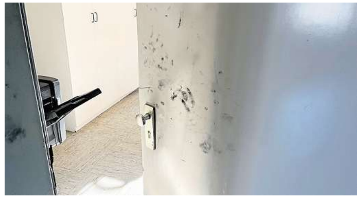
Spuren des Einbruchs: Die Täter haben die Tür zu einem Materialraum der Grundschule aufgebrochen. Foto: Julia Braun
