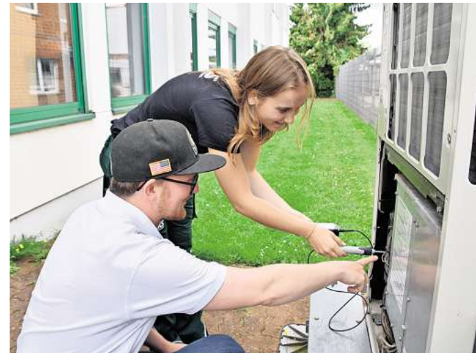
Ausbildung in Garbsen: In der Firma RKS prüft Catalina Buhl mit dem Ausbildungsbeauftragten Niclas Höfler die Außeninheit einer Klimaanlage. Auch dieses Unternehmen ist bei der Berufsmesse vertreten. Foto: Gerko Naumann
