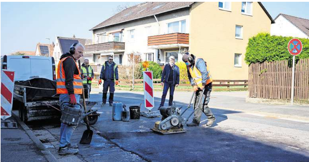
Fachgerechte Reparaturen am Westerwinkel: Beschäftigte der Straßenbaufirma glätten den heißen Asphalt und rütteln ihn ab. Bürgermeister Alexander Masthoff (Mitte) verschafft sich einen Eindruck von den Arbeiten. Nach rund einer Stunde ist die Fahrbahn wieder für den Verkehr freigegeben.
