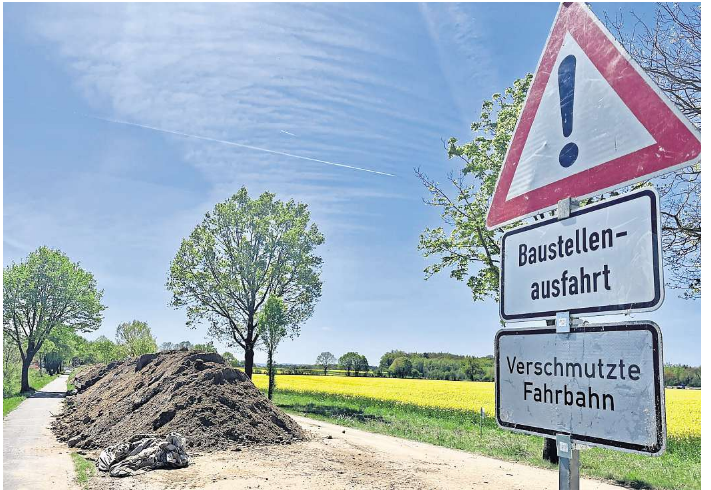
Auf der Frieling Seite: Vor den Bergen mit dem Aushub von den Bauarbeiten an der Kreisstraße 322 warnt ein Schild vor der verschmutzten Fahrbahn.
