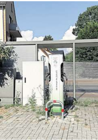
Eine E-Ladesäule ist auch vorhanden. Foto: Reimann
