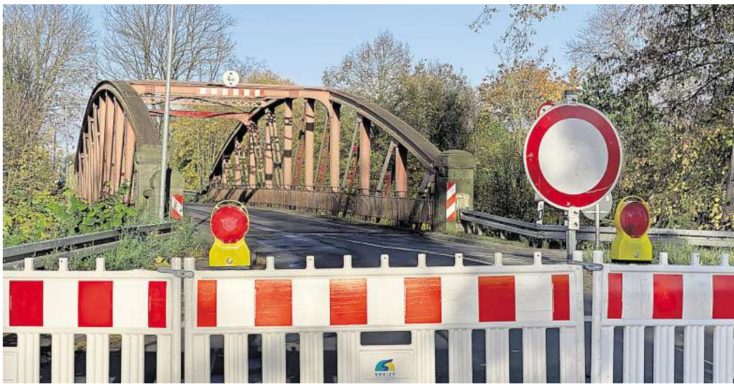
Gesperrt wegen Mängeln.
