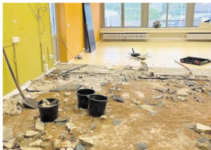
Baustelle: Der Wasserschaden hat das Leben im Kulturhaus Kalle vorübergehend lahmgelegt. Foto: Stadt Garbsen
