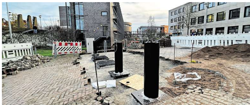
An allen vier Zufahrten zum Rathausplatz werden solche Poller aufgestellt.
