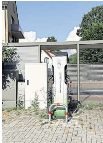
Eine E-Ladesäule ist auch vorhanden. Foto: Reimann
