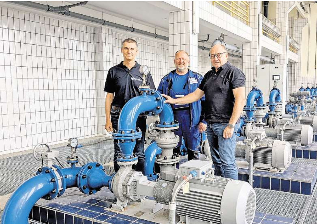
Sie informieren sich in der Pumpenhalle des Wasserverbands Garbsen-Neustadt: Marcus Möser (von links), Jens Kielhorn und Sebastian Kratz. Fotos: Jutta Grätz (2)
