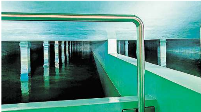
Noch gut gefüllt: die Wasserbehälter des Wasserverbands Garbsen-Neustadt am Standort Gehrbreite.
